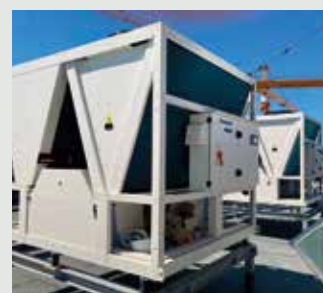
Cédrus Liget ungherese. Una struttura complessa che comprende appartamenti, uffici e attività commerciali. Szeged, Ungheria. ECOi-W, ECOi ed ERV.
