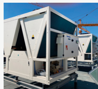
CÉDRUS LIGET, en avancerad anläggning med bl.a. lägenheter, takvåningar och utställningslokaler. Szeged, Ungern. ECOi-W, ECOi og ERV.
