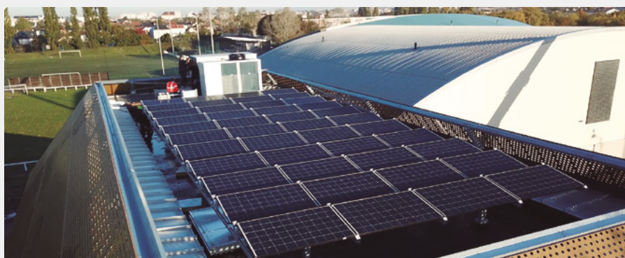
Amandiers. Idrettsanlegg. Carrierre sur Seine, Frankrike. ECOi-W
