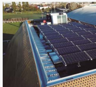
Amandiers. Idrettsanlegg. Carrierre sur Seine, Frankrike. ECOi-W.
