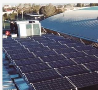
Amandiers Idrettsanlegg. Carrierre sur Seine, Frankrike. ECOi-W.
