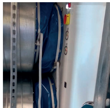
Wysokoprężny wentylator (HP).
