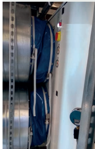
Wysokoprężny wentylator (HP).
