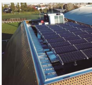
Amandiers. Idrottsanläggning. Carrierre sur Seine, Frankrike. ECOi-W.
